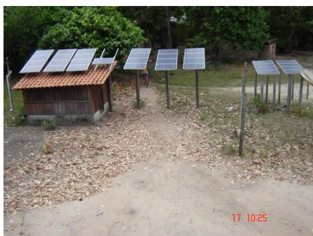
Fotografia 21 – Placas de armazenamento de energia solar do telecentro (em funcionamento) Fonte: Heidtmann Neto (2007)
