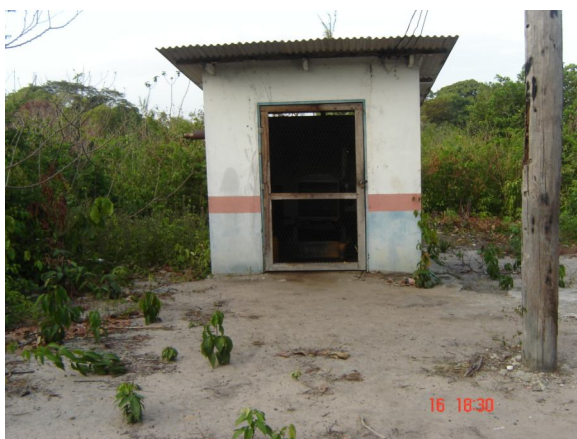
Fotografia 27 – O gerador de energia movido a combustível
